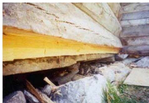
32. Koret: Vegg YC. Råteskada svill.
