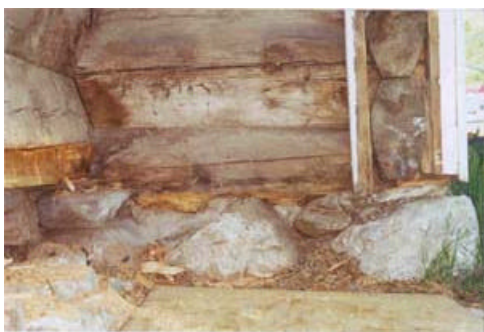
18. Skipet: Vegg Y. Demontera utvendig kledning. Råteskade på svilla og hjørne.
