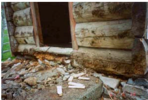
1. Våpenhuset: Dørsvilla hadde store råteskada.
