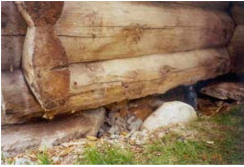
20. Skipet: Vegg CCC. Demontera muren og utvendig kledning. Råte skada svill.
