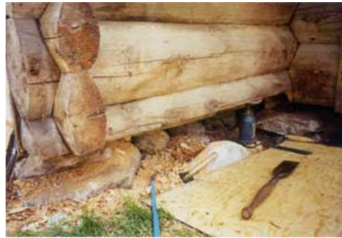
21. Skipet: Vegg CCC. Demontera muren og utvendig kledning. Råte skada svill.
